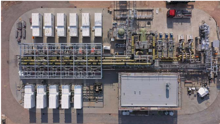
Blick von oben: Elektrolyse-Anlage von Linde in Leuna.
